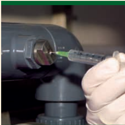
Bij oudere systemen ontbreekt soms een tappunt, bij de nieuwere niet.
