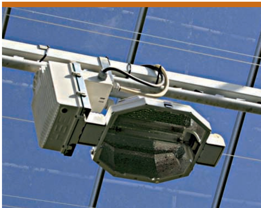
Wie goed kijkt, ziet dat er een extra grijs snoer aan de armatuur zit, naast het witte stroomsnoer. Het grijze snoer heeft verbinding met de klimaatcomputer.
