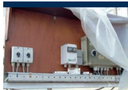
Voedings- en besturingspanelen onder een kasdek zijn kwetsbaar voor waterschade.
