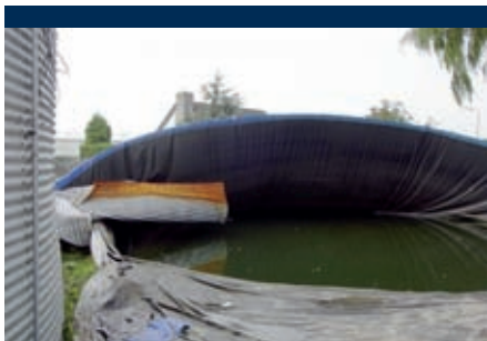
Imploderende buffertanks en klappende silo's kunnen enorme gevolgschade geven.
