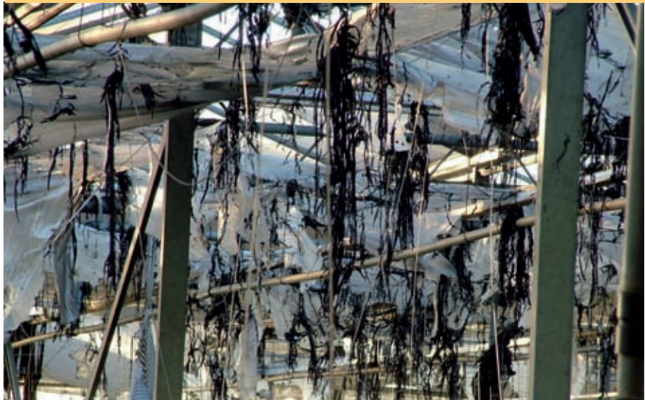
Bij hogere harmonischen slijten de condensatoren sneller met meer kans op overbelasting. Daardoor neemt de kans op brand toe.
