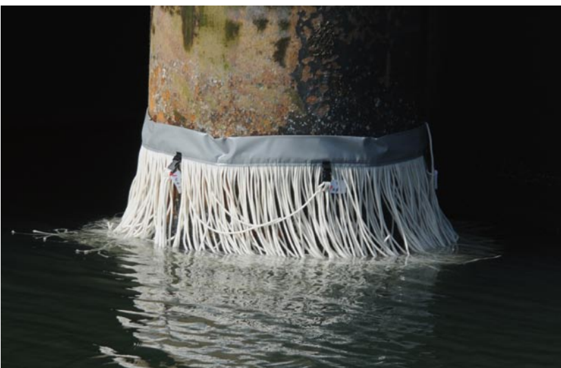
De hula's zitten als een Hawaïaanse rokje rond de steigerpalen, de meeste permanent onder water.
