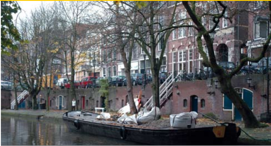
Van den Brink: "Voor de renovatiewerkzaamheden plaatsen we kleine graafmachines en kranen op een boot en doen de graafwerkzaamheden vervolgens vanaf het water. De graafmachine mag ook niet te hoog zijn, omdat hij ook onder de bruggetjes door moet kunnen."
