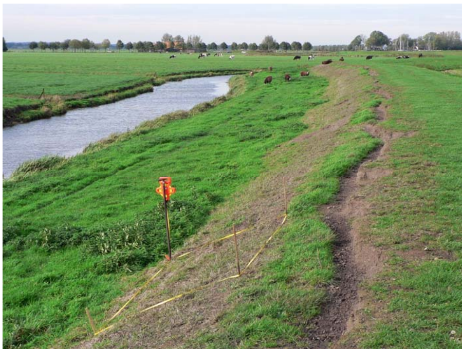
Bodemvervonding en kale plekken in dijkvak 7.
