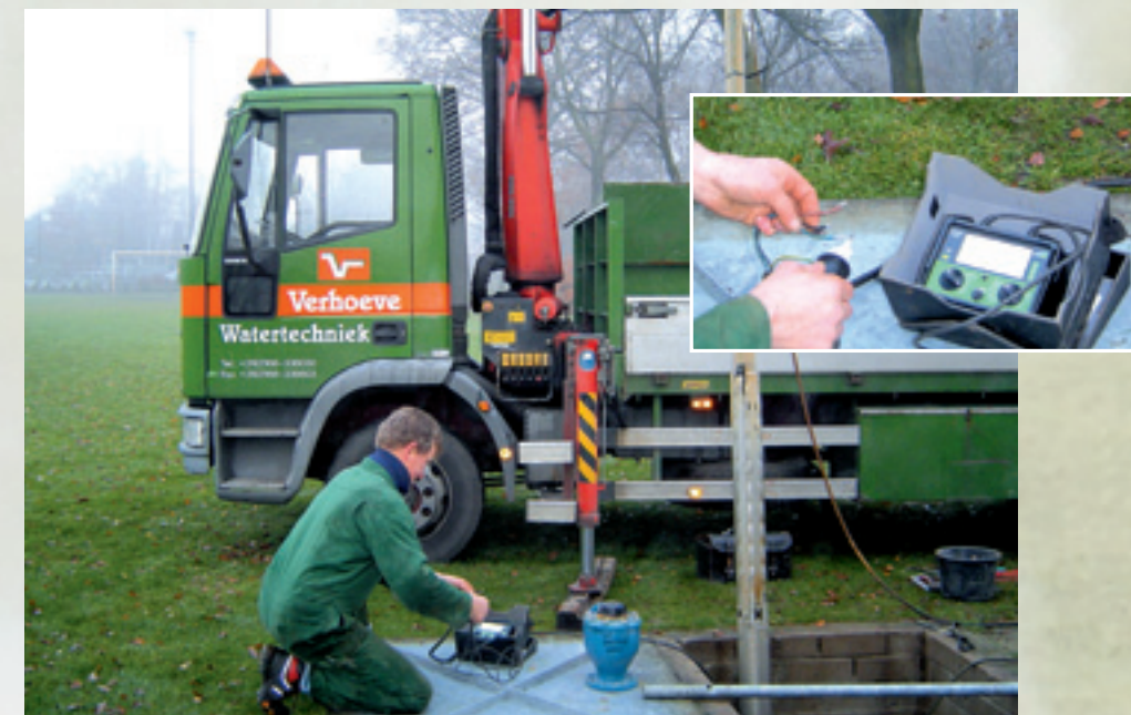
Door de pompinstallatie door te meten, krijg je een indicatie over de conditie van de motor. Dit kan zoals hier met een professionele meter de wikkelingen doormeten onder volledige spanning om eventuele lekstromen te vinden. Dit kan overigens ook met een eenvoudige ohm-meter.
