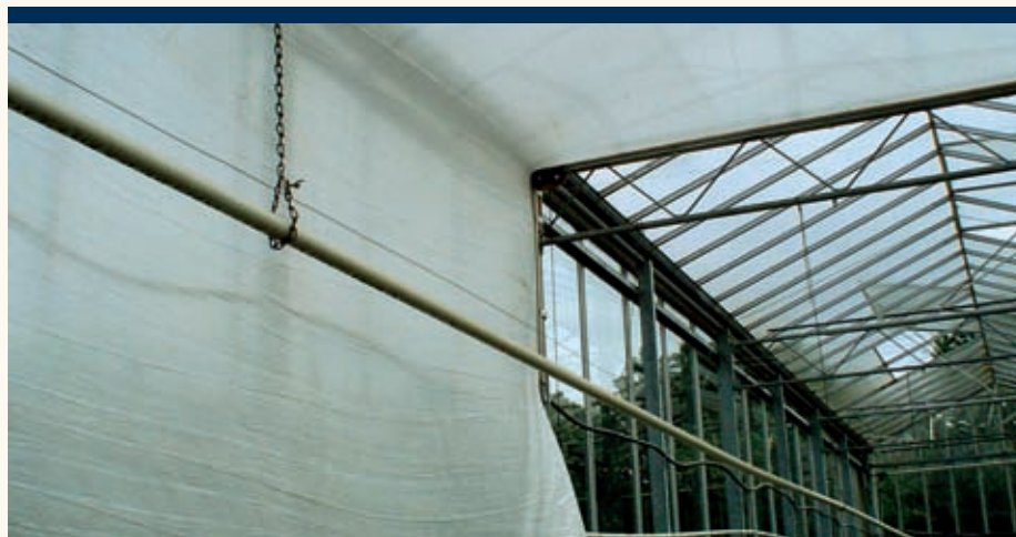
Rondgaande, gekraalde staalkabels trekken het ACL-scherm door profielen langs de tralieliggers over de volle breedte van de kas (foto: ACL Protections).
