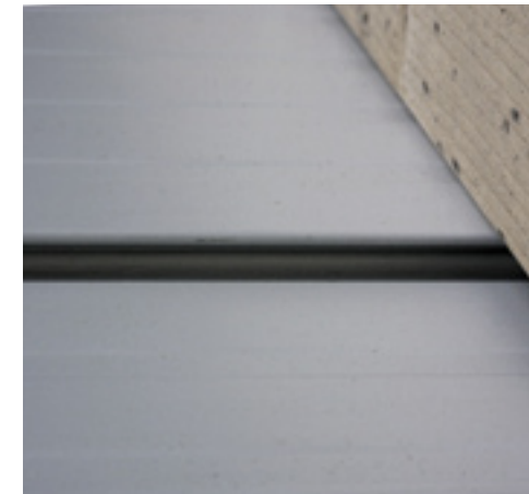
Via naden gaat veel warmte verloren.
