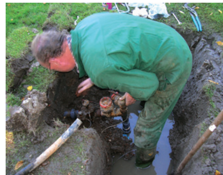
Een lek in een leiding is te repareren, al heb je zo'n gat natuurlijk liever niet op de baan. PVC-leidingen gaan echter na verloop van jaren door veroudering lekken en dan wordt het vernieuwen in plaats van repareren. PE-leidingen gaan daarentegen langer mee.
