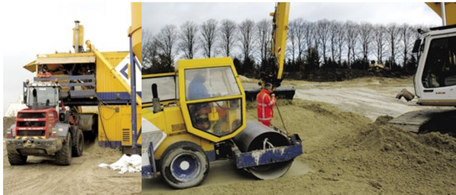
Bij de aanleg van vijvers met Trisoplast op een nieuwe golfbaan gaat het ook bij een laagdikte van 6-7 centimeter om behoorlijk wat kuubs. Daarom worden zand, bentoniet en polymeer ter plaatse gemengd: 1.000 kilo zand, 130 kilo bentoniet en 2,6 kilo polymeer.
