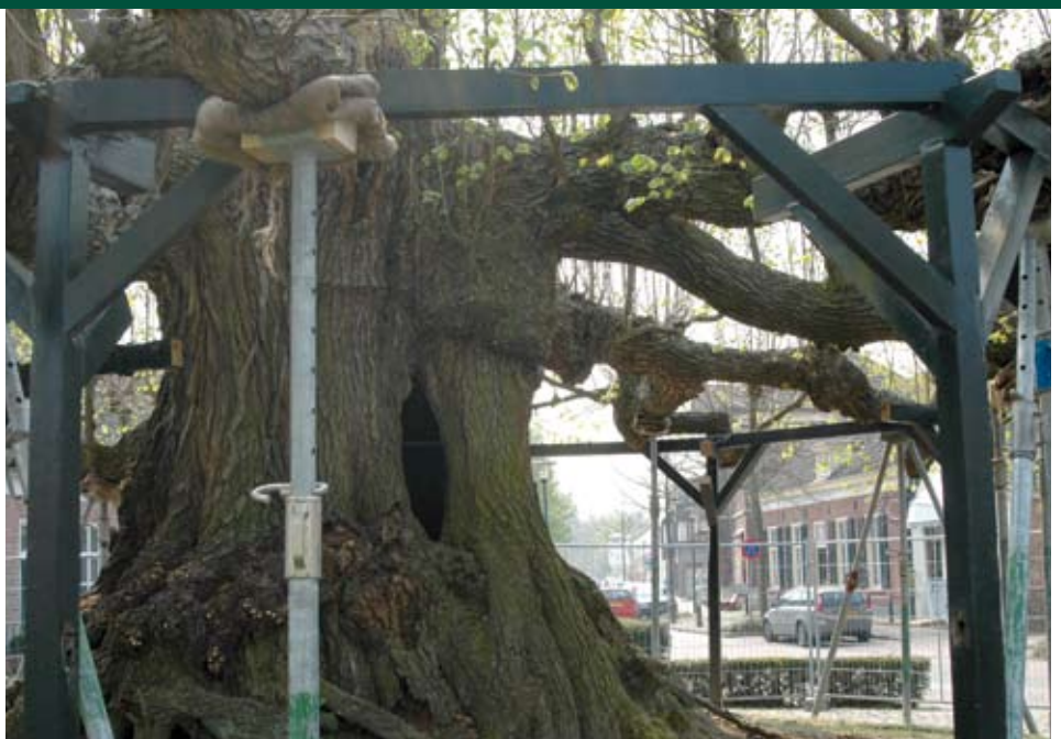
De takken worden gestut door stempels. Hierdoor kan de oude leiconstructie er onderuit gehaald worden.
