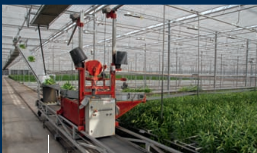
Bij Koorneef kan de BTM-band op het hoofdpad bij elke kap naar beneden. De bloemen gaan via een band in de kap naar de band boven het middenpad.
