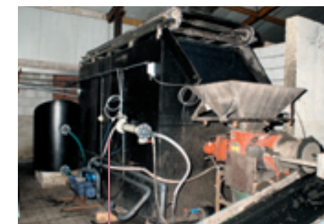
FLOTATIE-UNIT EN VIJZELPERS
