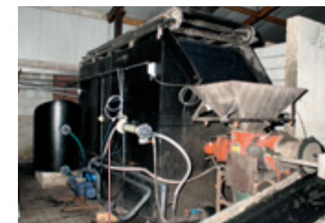
FLOTATIE-UNIT EN VIJZELPERS
