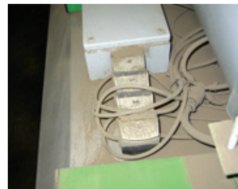
De slangenpompjes zijn bovenop de kap gemonteerd. Voor elke schijfvernevelaar is een slangenpompje voor de wateraanvoer.
