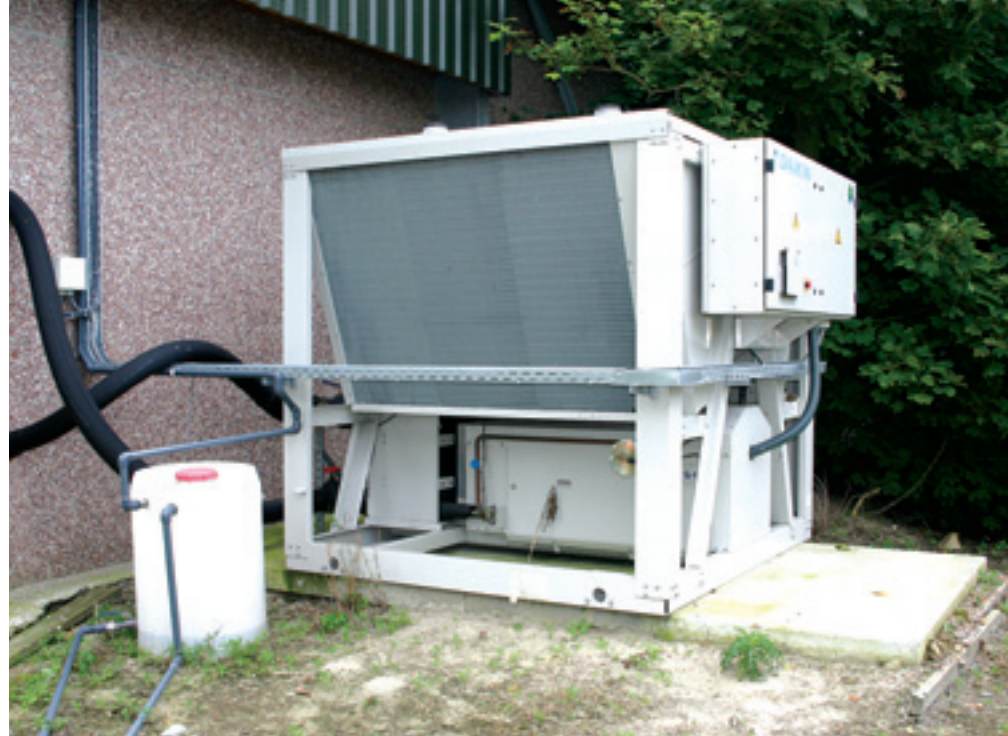
De ijswaterkoeler (chiller) staat buiten de bewaring en maakt koud water aan. De twee leidingen zorgen voor aan- en afvoer van water tussen de chiller en de radiatoren in de bewaring.
