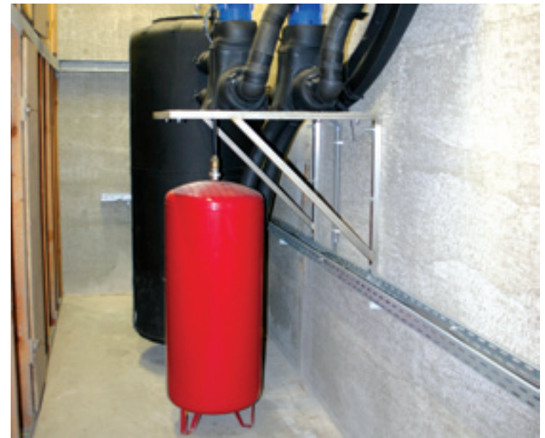
In de drukkamer is het expansie-orgaan geplaatst. Doordat de koelmachinekringloop berust op het afwisselend condenseren en verdampen van het koudemiddel, is er steeds een drukwisseling. Het expansie-orgaan vangt deze drukschommelingen op.
