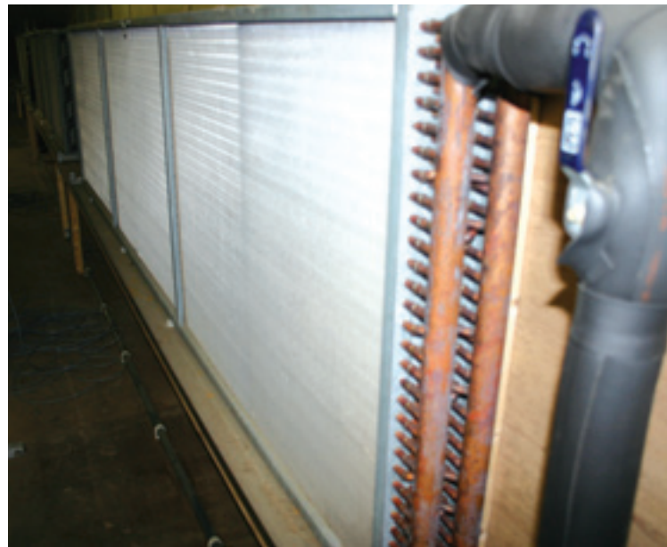
De radiatoren in de bewaring. Door de kleppen bovenop de radiatoren te sluiten, wordt de lucht gedwongen door de radiatoren te gaan. Deze koelen de lucht af en de koude lucht wordt vervolgens weer door het te bewaren product geblazen.
