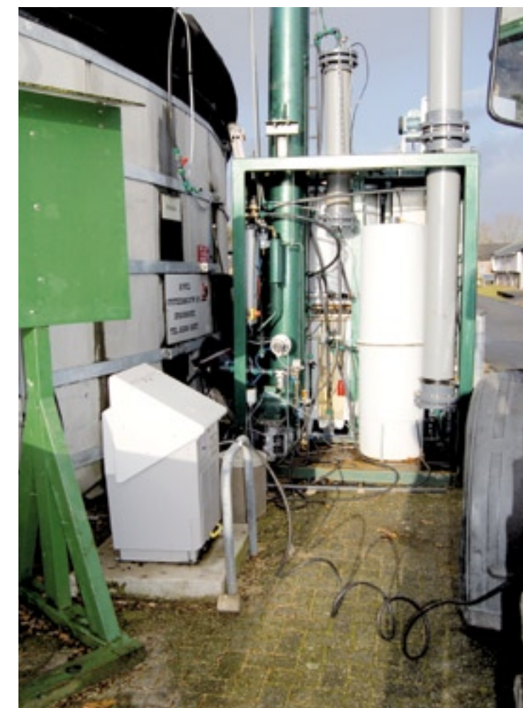
▲ Het gastanken aan de tankzuil. Op de achtergrond onder meer de gaswaster (groene kolom) die het biogas uit de mestvergister reinigt.
