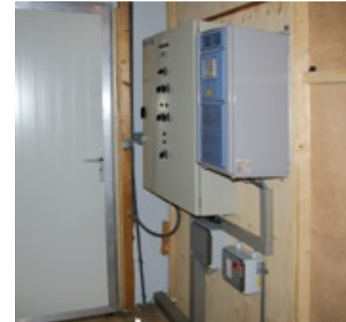
▲ Deze frequentieregelaar heeft een eigen kast en koeling.
