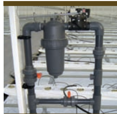
Filters bij ieder kraanvak beperken de vervuiling van het systeem en vereenvoudigen de controle daarop.
