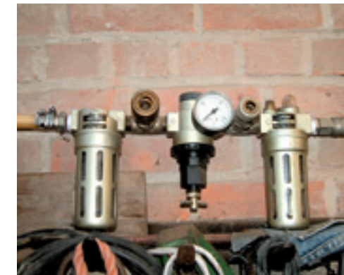
Een automatisch smeersysteem. Links de opvang van water, rechts het oliereservoir. De drukregelaar zit ertussen.
