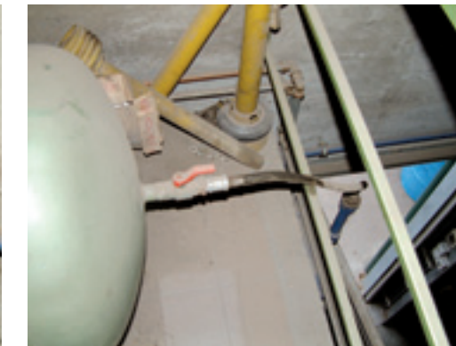
De aansluiting van de compressor op zolder op het leidingnet.
