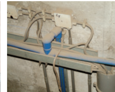
De kunststof luchtleidingen zijn weggewerkt in een kabelgoot.
