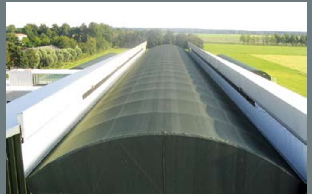
De nok op de nieuwe melkveestal op de Waiboerhoeve in Lelystad. De acht meter brede folie-nok is verdiept in de nok gemonteerd waardoor de stal 2 meter minder hoog werd. Het folie verspreidt het licht door de hele stal.
