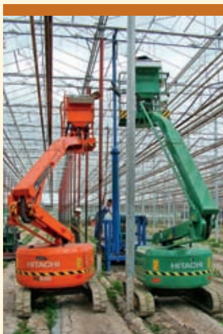
Om de belichte teelt van tomaten mogelijk te maken, is de kas van 4,15 m naar 7,30 m goothoogte gebracht.
