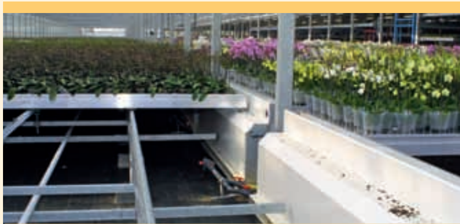
De JSK-koelunits staan onder de goot tussen de teelttafels. Ze zuigen van boven lucht aan, koelen of verwarmen deze en blazen de lucht vervolgens horizontaal onder de teelttafels de kas in.
