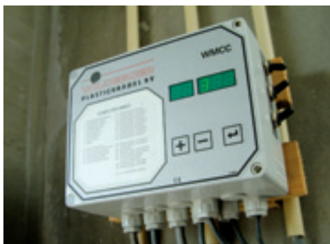
De klimaatregeling van Hotraco; hier in de uitvoering van Wildeboer, die met drie knoppen is te bedienen. Met de schakelaars aan de zijkant van de kast zijn de gordijnen aan beide zijden van de stal afzonderlijk én met de hand te bedienen.
