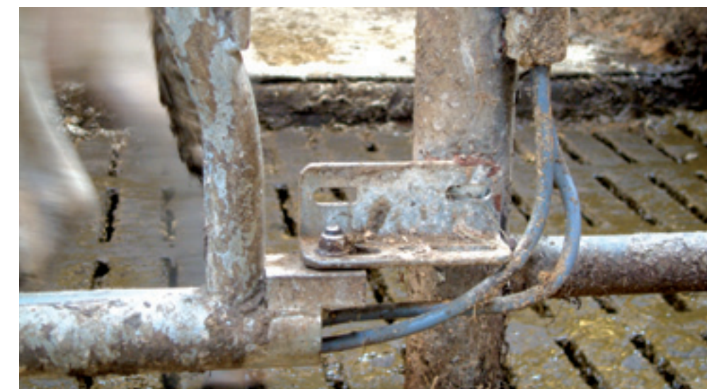
De stroomtoevoer van de zes groepen loopt via dikke kabels in de onderboom van het hek.
