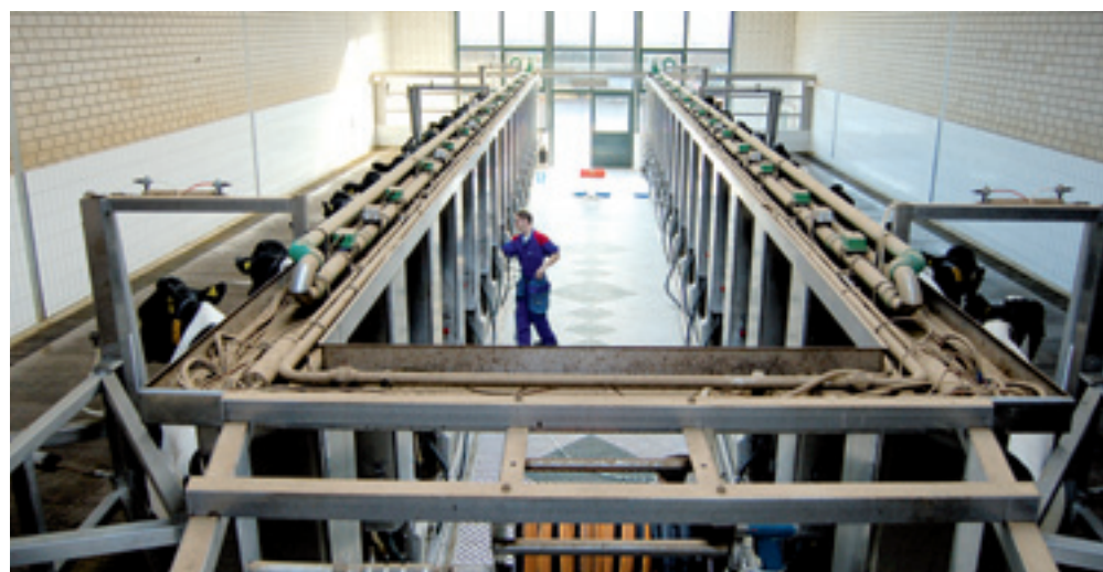
Bovenop de melkstal liggen alle leidingen. De constructie heeft geen overspanningen en leunt geheel op de putrand.
