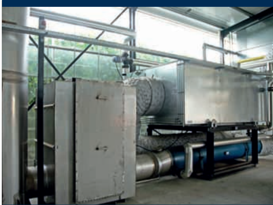
Een glazen wand tussen kas en ketelruimte vormt op veel bedrijven een schaderisico. Alleen al door rook en roet bij het springen van het glas kan het gewas in de achterliggende teeltruimte compleet verloren gaan.
