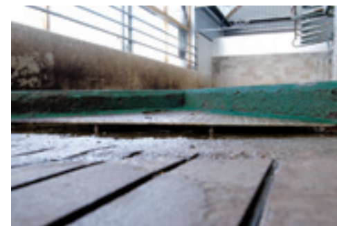
Uit de meter brede flushkop spoelt het water vermengd met mest over de vloer van de wachtruimte.
