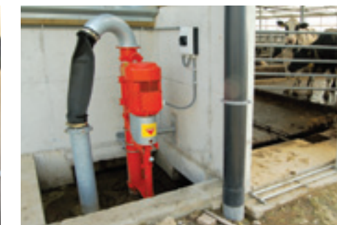
Een 11 kW pomp zuigt het water uit de 50 kuubs put en laat het recirculeren.
