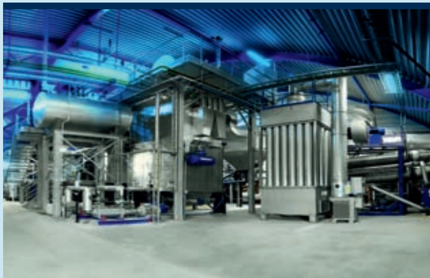
De houtgestookte WKK-installatie met van links naar rechts: ontluchter, waterpijpketel, multi cycloon, elektrostatisch filter, rookgascondensor en cycloon.
