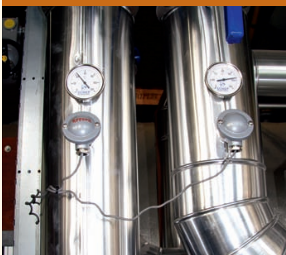
Water komt op 95°C bij de afnemers aan. Via een warmtewisselaar wordt lokaal water opgewarmd van plusminus 45°C naar ongeveer 90°C.
