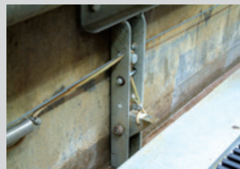
De vloer rust op 10 palletjes die werken als deurklinken. Deze zijn centraal te ontgrendelen wanneer de vloer naar beneden moet.
