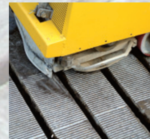
Wie een goed begaanbare vloer wil maken kan het best een diamantslijpmachine gebruiken.
