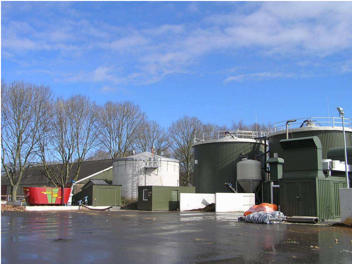
Een operationele installatie (Touw) in het project Biogas Flevoland
