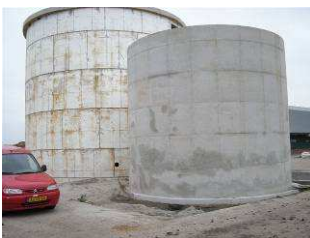
Foto rechts, bouw installatie Mts van der Knaap. Op de voorgrond de hydrolyse en daarachter de staande vergister.
