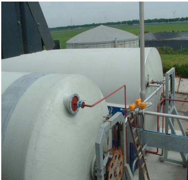
Tweede fase met op achtergrond navergistersilo en foliebassin.
