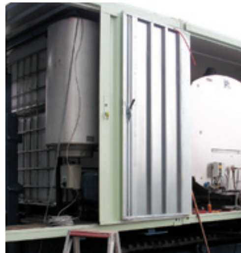
In de tweede container, op de achterkant van de rupsdumper, is de boiler en warmteterugwinningsinstallatie geplaatst.
