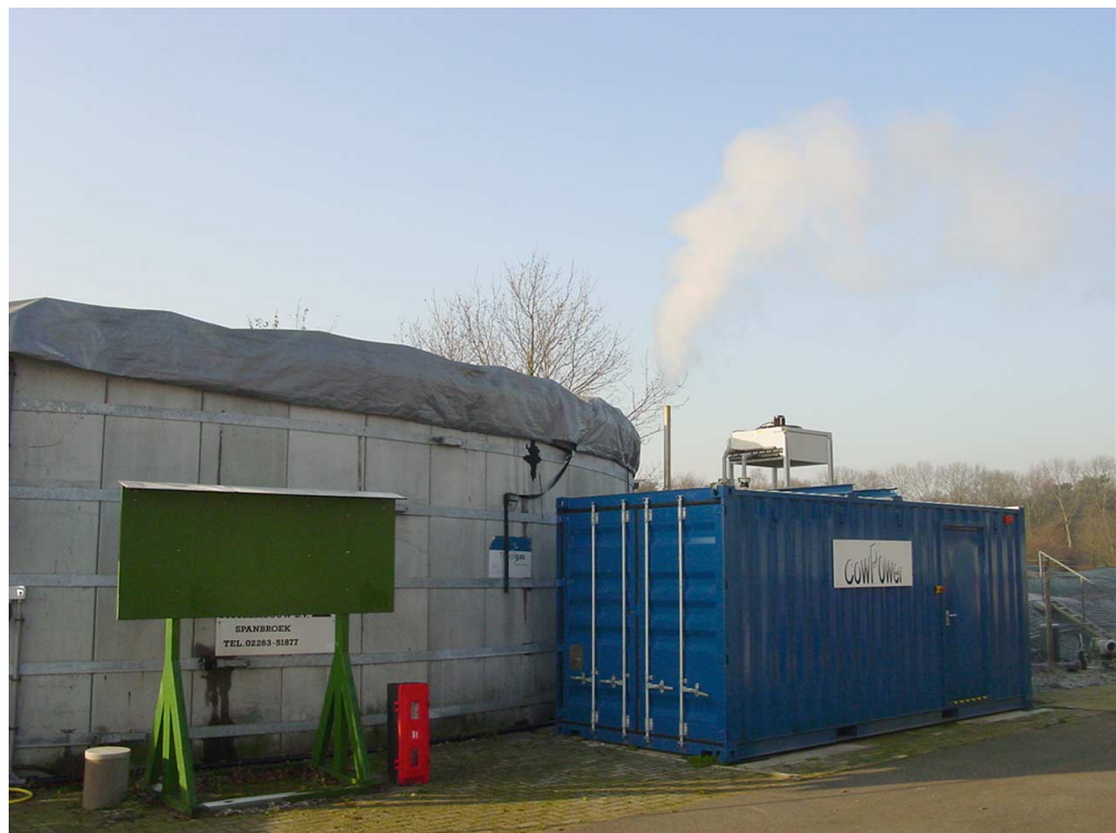
De vergistingsinstallatie op De Marke
