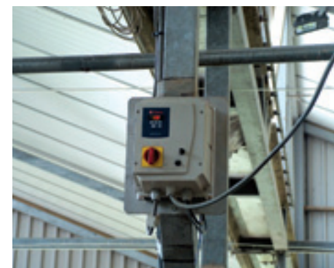
Een frequentieregelaar zorgt ervoor dat de ventilator langzaam opstart en op verschillende toerentallen kan draaien.
