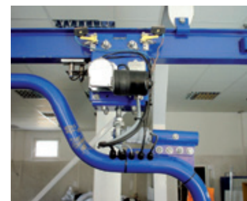
De koppeling van de Feedshuttle met de rails ligt bloot. Boven de twee contactpunten om op te laden. Links naast de elektromotor de twee geluidssensoren die de dikte van het blokje bepalen.
