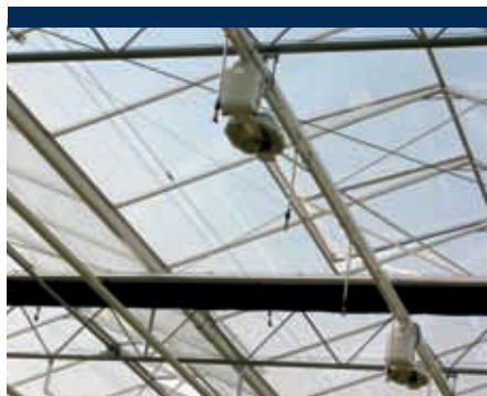
Het watergeefstelsel is tussen de lampen weggewerkt. De lampen hangen op 3,30 meter afstand. Daartussen hangen drie sproeiers, die zorgen voor de waterverdeling.
