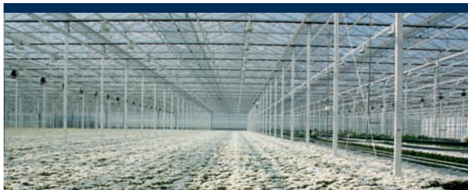
Op het nieuwe bedrijf hangen 2.900 lampen van 1.000 watt. Voor de elektriciteitsproductie beschikt het bedrijf over een WKK van 1.160 en een van 1.560 kWe.
