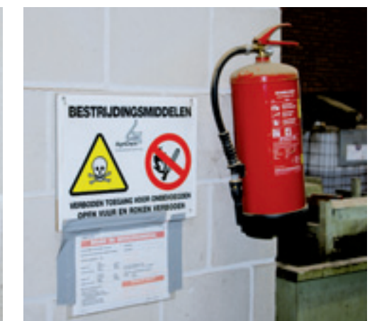
▲ Brandblusapparatuur en bordjes zijn verplicht bij opslag van gewasbeschermingsmiddelen.
