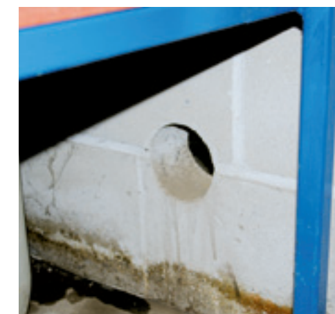
▲ Dit is fout. Ook ventilatiegaten moeten brandwerende roosters krijgen.
