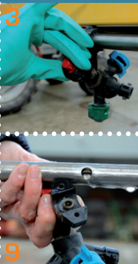
3 Wanneer het betreffende leidingdeel is losgemaakt, kun je de dophouders demonteren. Een visuele controle op uitwendige haarscheurtjes is dan meteen te combineren.
