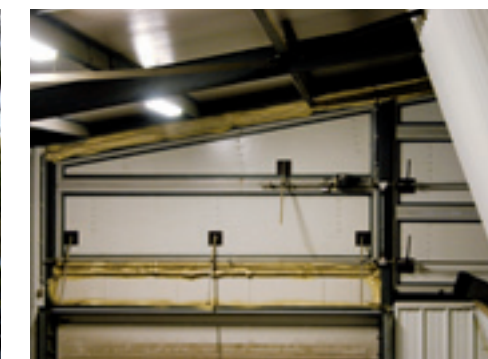
▲ Door de uitlaatluiken gaat weliswaar minder geluid dan door de inlaatluiken, maar isoleren helpt toch goed. Door ook deze luiken onder een overstek te plaatsen, kan het geluid worden 'doodgemaakt'.
