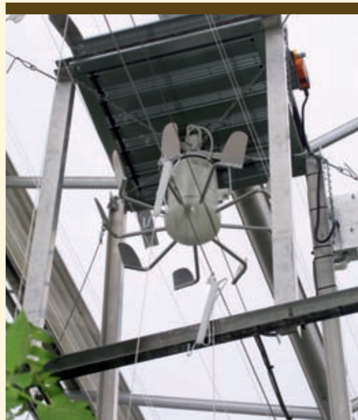
In Bleiswijk zijn boven de Aircobreeze-ventilator lamellen geplaatst, waarmee de hoeveelheid van boven het scherm aangezogen lucht wordt geregeld.
