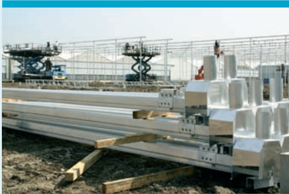
De nieuwe Venlo-kas heeft een pothoogte van 5,60 m en een traliemaat van 9,60 m.
