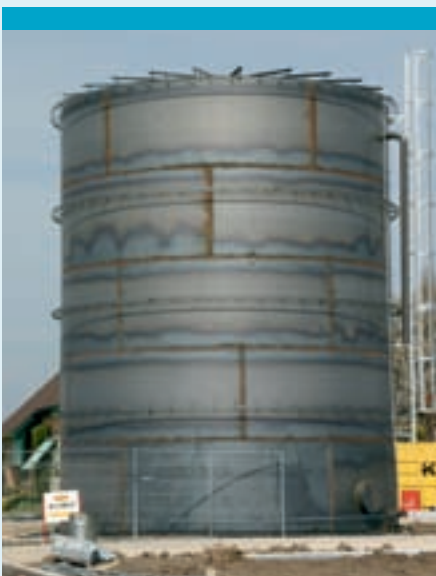
Op het nieuwe bedrijf staat ook een warmteopslagtank.
