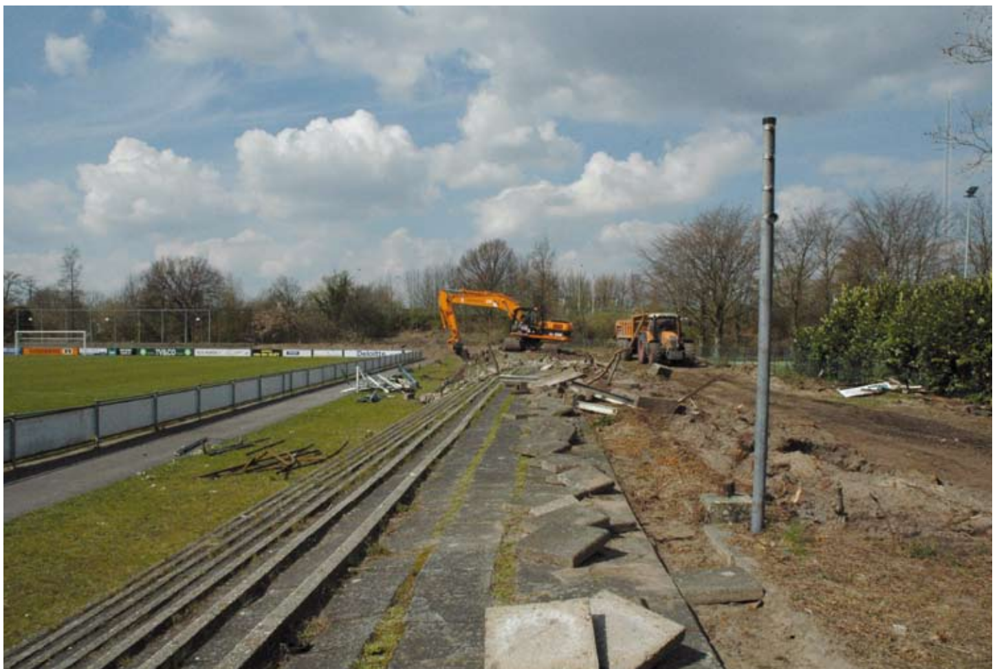
Puinruimers slegen de rommel en van de half afgebroken oude tribune en zand weg tegenover en aan weerszijde van de hoofdtribune bij hoofdklasser Baronie.
