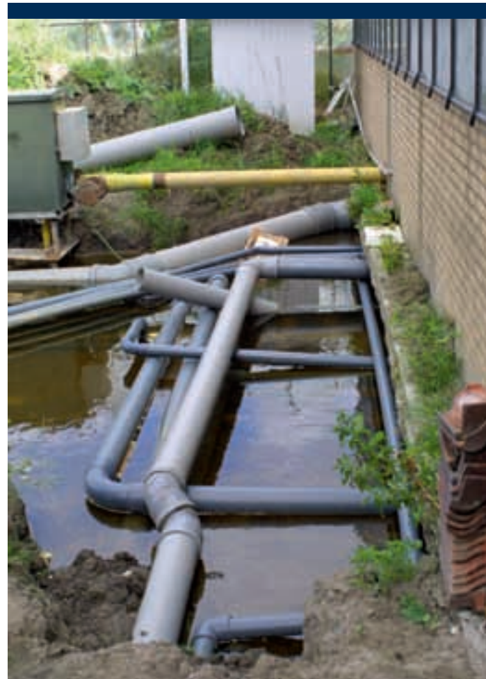
Weet waar leidingen liggen en leg de eigen leidingen vast in een 'as built' of revisietekening.
