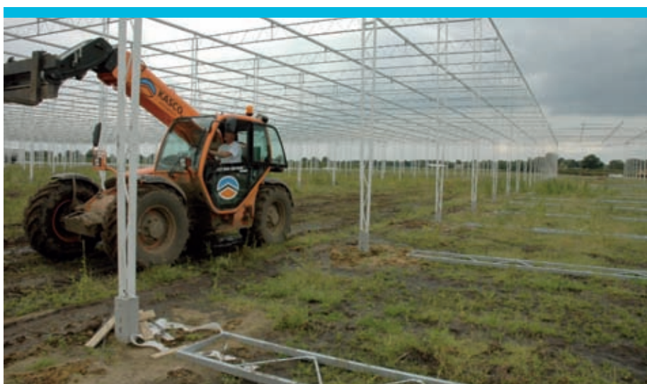
Komkommerteler Frank van Lipzig bouwt een kas met een pothoogte van 7,10 meter. De toegepaste vakwerkconstructie bij de staanders vraagt flink wat minder staal dan bij de gangbare kolommen.
