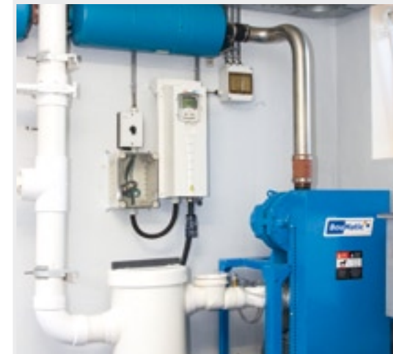
De schroefpomp is voorzien van een frequentieregelaar. Dit bespaart energie en beperkt het geluidsniveau.
