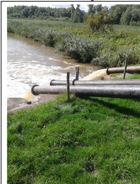
Figuur 24: Afvoer noodpompen
