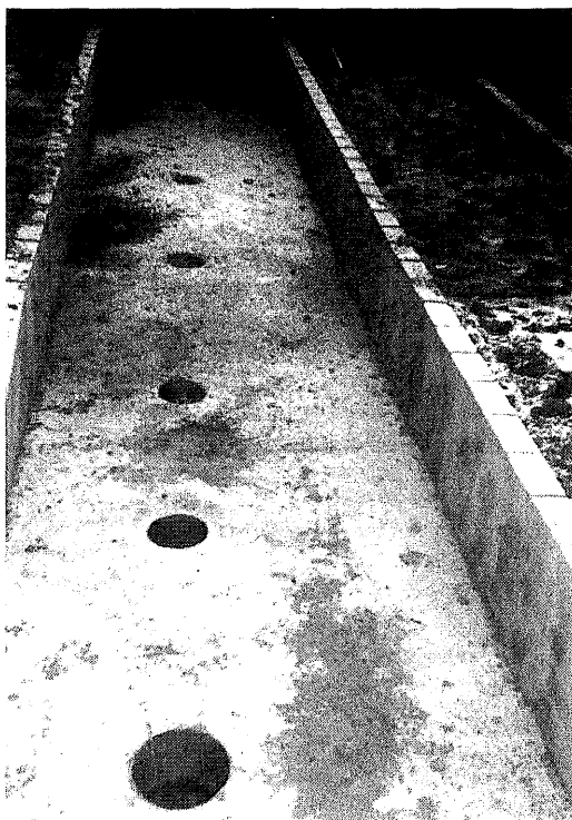
Foto: Ondiep mestkanaal met open verbindingen naar rioleringssysteem.
